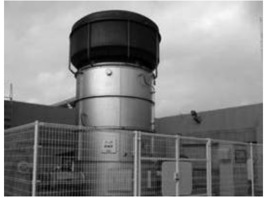
写真2 排煙処理設備
